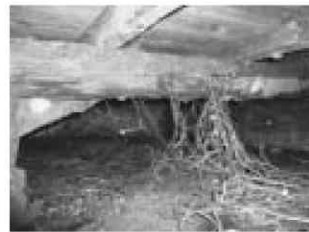
写真4 床下に放置されているカズラの蔓
