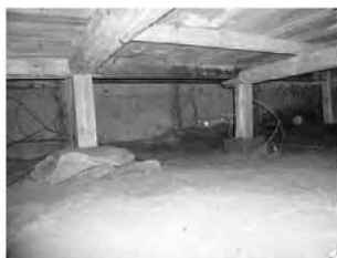
写真7 家屋の床下。床下空間は60cm程度あり、状態は良好であった
