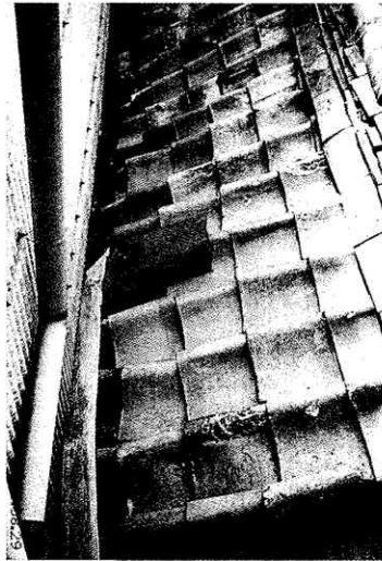
写真19 隣家の屋根から流入する雨水
